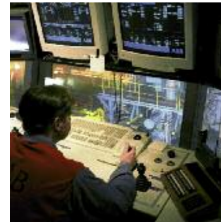
Elektrik und Automation von SMS Siemag steuern sämtliche Prozesse der Hütten- und Walzwerkstechnik
